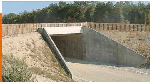
Passage faune sur la LGV Est
