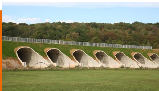
Ouvrage de décharge - Evreux
