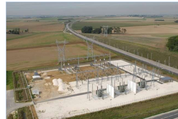
Photo 3 : Exemple de sous-station électrique (Source : SNCF Réseau)
