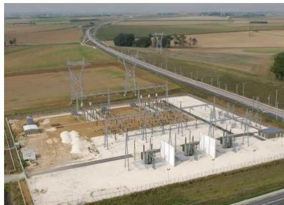
Photo 12 : Sous-station électrique (Source : SNCF Réseau)
