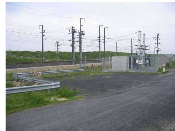
Photo 23 : Poste d'auto-transformation et son accès routier (Source : SNCF Réseau)
