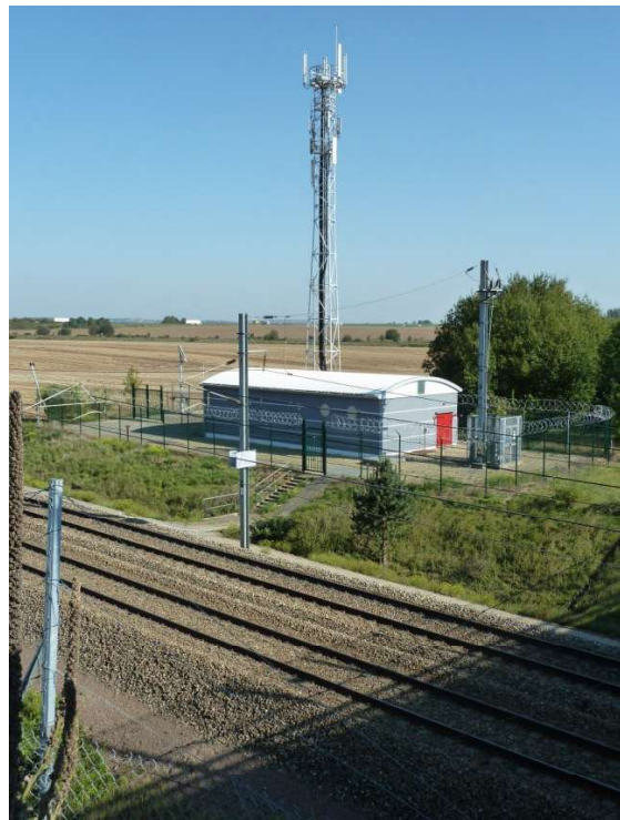
Photo 19 : Centre de signalisation et antenne GSM-R (Source : INGEROP)
