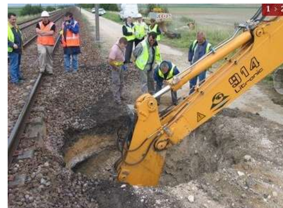
Photo 1 : Effondrement des terrains sous la voie ferrée (Source : Choisy le Roi, Val de Marne (23 janvier 2012))
