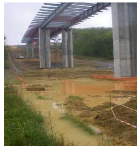
Photo 2 : Ruissellement et départ massif de matière en suspension sur terre décapée (Source : Onema)
