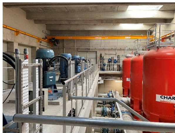
Salles des pompes dans le nouveau bâtiment construit en 2011.
