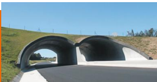
Passage faune sur l'A9
