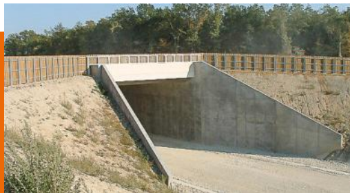
Passage faune sur la LGV Est
