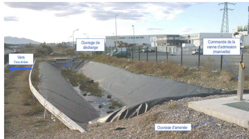
Photographie 2 : Exemple de bassin de confinement (BC)
