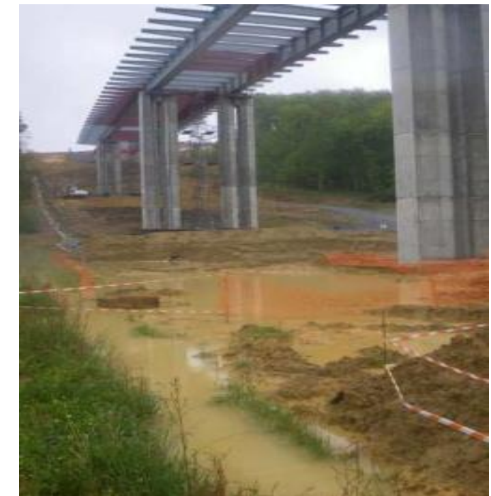
Photo 6 : Ruissellement et départ massif de matière en suspension sur terre décapée (source : Onema)
