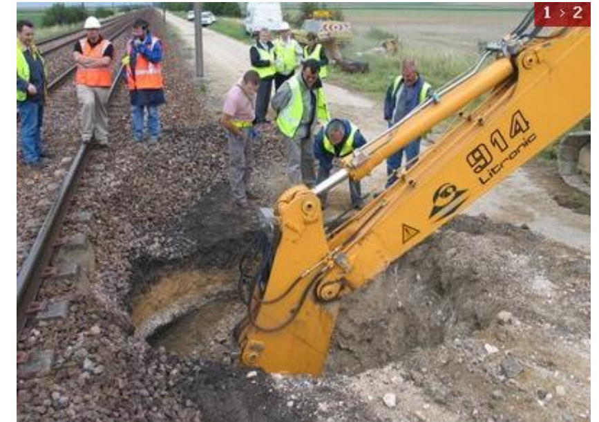
Photo 4 : Effondrement des terrains sous la voie ferrée (Source : Choisy le Roi, Val de Marne (23 janvier 2012))
