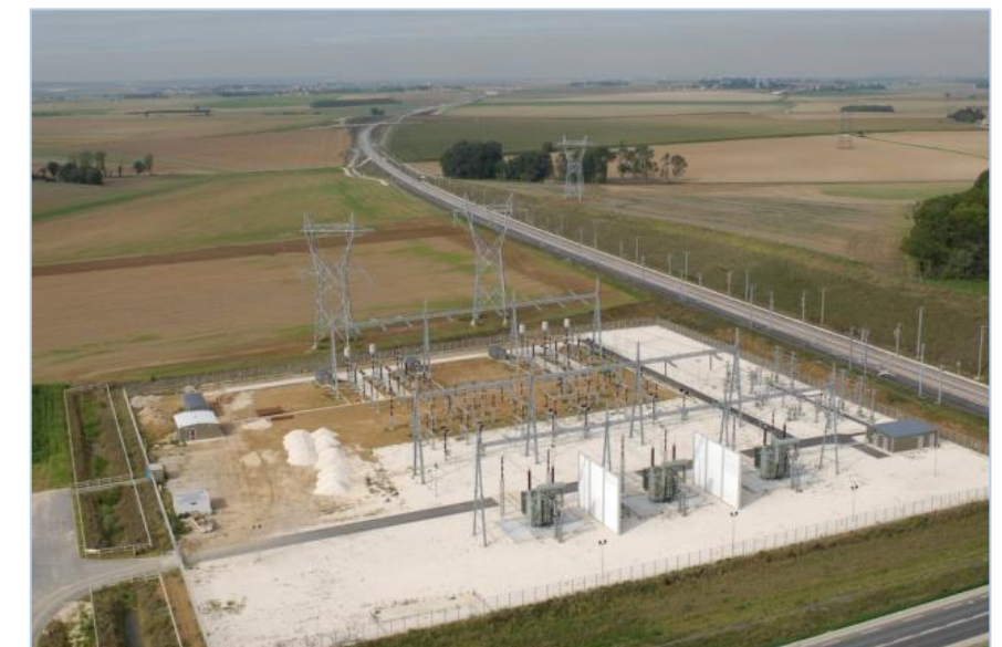
Photo 3 : Exemple de sous-station électrique (source : SNCF Réseau)
